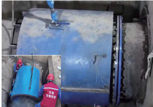
陕西某热力公司DN1200补偿器内波纹管泄漏，管道压力12公斤，正值供暖季无法停输更换，定制补偿器修补器进行带压修复。
