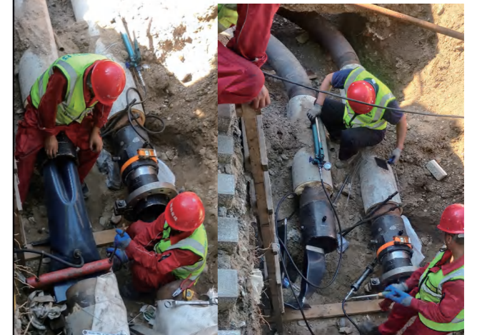
北京热力集团DN250供暖管道非开挖内衬修复，修复管段总长144米。
