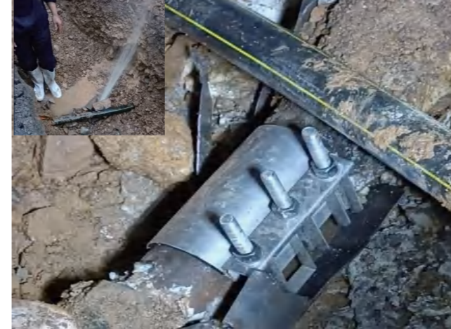
旅顺一小区每天失水60吨，经勘查发现一处DN100钢管直管处泄漏，漏点紧挨着燃气管道，空间狭小，管壁腐蚀严重，压力4公斤，正值供暖期间，无法停水，采用板式修补器进行带压堵漏。
