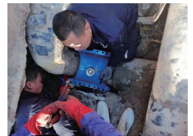
辽宁大石桥热力DN250球墨铸铁管发生泄漏，使用“良格”全包弯头修补器进行修复。
