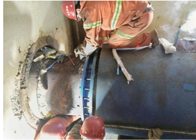
北京热力DN900补偿器波纹管漏水，管道压力11公斤，补偿器位于井下6米深位置，使用补偿器修补器进行带压抢修。
