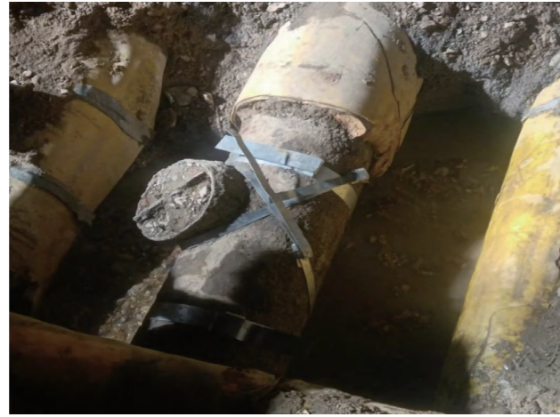
开发区东居小学一次管网直管旁通与管道连接处泄漏，DN350钢管，压力6公斤，无法停输，不能使用传统修补夹具，根据工况使用钢带拉紧技术进行带压修复。
