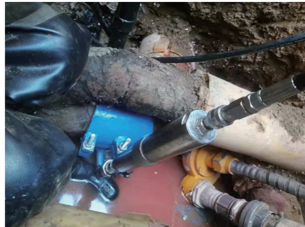
热力DN150钢管弯头处泄漏，漏点腐蚀严重，管壁较薄，压力4公斤，操作空间狭小，正值供暖期间，无法停水，定制卡具注胶堵漏。
