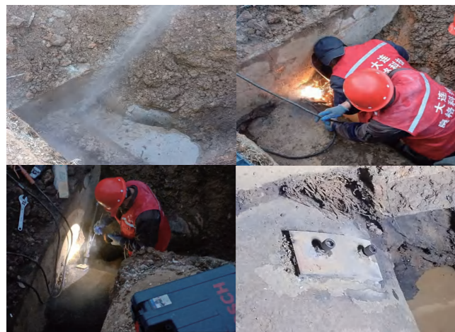
热力DN600铁管，压力12公斤，直管段腐蚀漏水，管道正下方是水泥墩，无法使用卡具，根据漏点定制卡瓦，焊接在管道上进行注胶堵漏。
