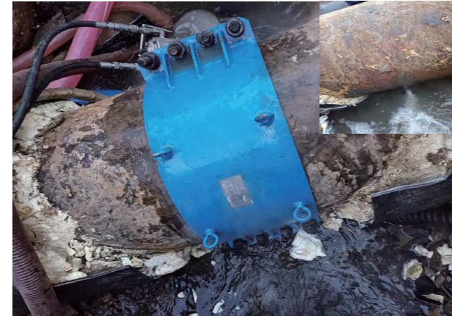
DN530热力钢管泄漏，管道压力6公斤，漏点大小1公分，海水倒灌，排水困难，正值供暖期间，无法停水，使用直管段修补器带压抢修。
