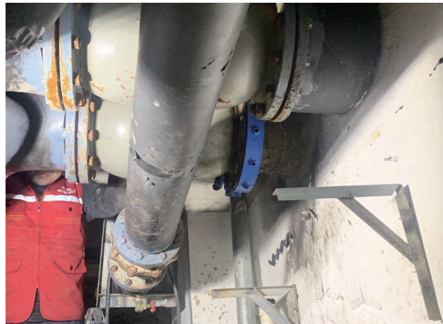
某小区地下车库热力铁管法兰盘对接处泄漏，管道外径273mm，压力6公斤，供暖季无法停输修复，定制法兰修补器注胶带压堵漏。
