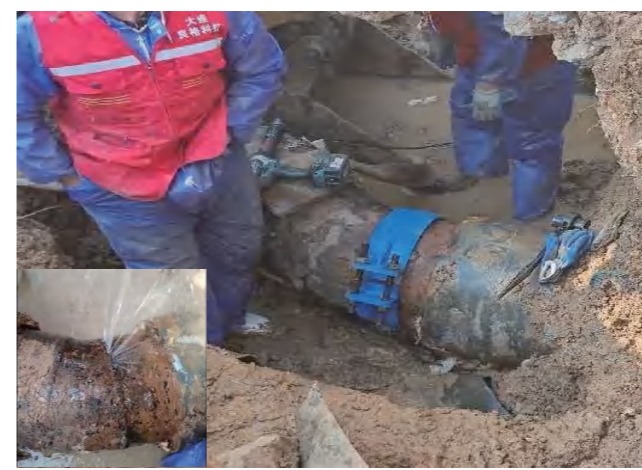
小区路边1米深位置，DN350螺旋焊管热力直管焊缝处泄漏，使用环缝修补器进行带压修复。
