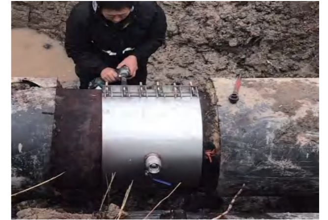
天津热力DN600螺旋焊管发生泄漏，由于处在供暖季，无法停输维修，使用“良格”修补器进行快速带压抢修。
